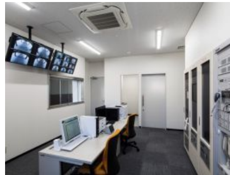
24時間365日稼働の防災センター
