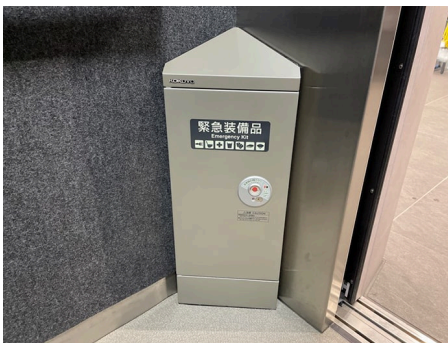
防災キャビネットの設置
