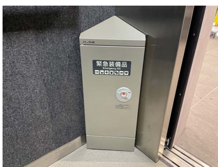
防災キャビネットの設置
