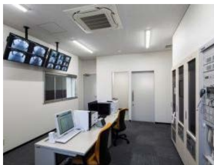
24時間365日稼働の防災センター
