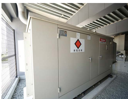
非常用発電機の設置
