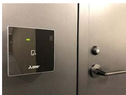
入退館管理システムによるセキュリティの確保
