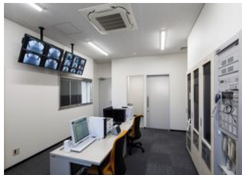
24時間365日稼働の防災センター
