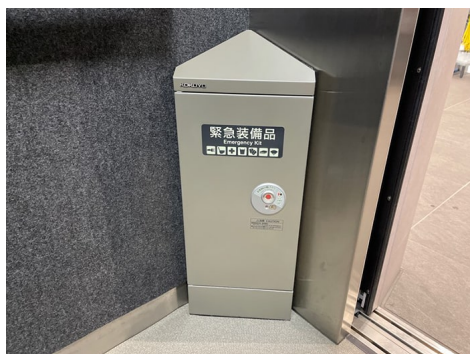
防災キャビネットの設置
