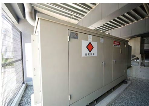
非常用発電機の設置
