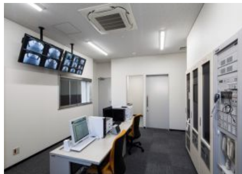
24時間365日稼働の防災センター
