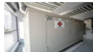
非常用発電設備の設置
