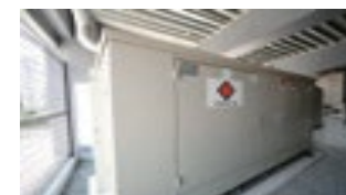
非常用発電設備の設置
