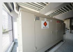
非常用発電機の設置
