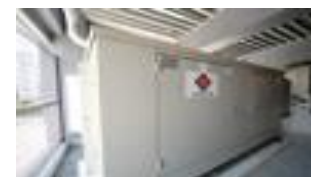
非常用発電設備の設置
