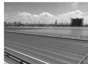
太陽光パネル
