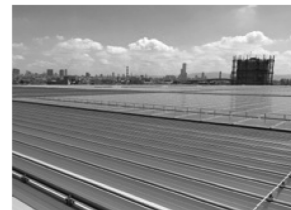
太陽光パネル
