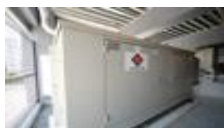
非常用発電設備の設置
