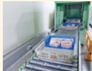
2階で加工した商品を出荷エリアへ送る専用エレベーター
