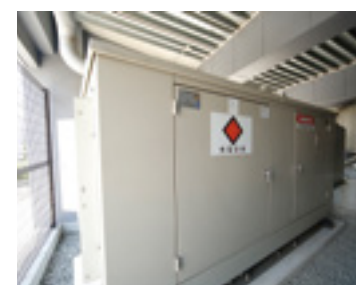
非常用発電機の設置
