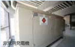
非常用発電機 BCP (注1) 対策による停電時の事業継続サポート
