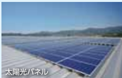
太陽光パネル 環境に配慮した再生可能エネルギーの活用(ロジクロス福岡久山)
