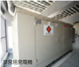
非常用発電機 BCP (注4) 対策による 停電時の事業継続サポート
